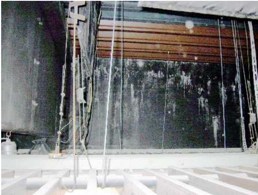
Bild 7: Darstellung des Konglomerates an unterschiedlichen Abhängern der Unterdecke (Anmerkung: braune und schwarz lackierte Trapezbleche sind zu erkennen)
