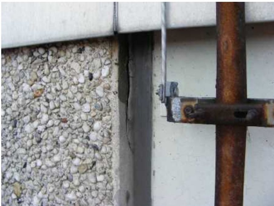
Bild 20: Flankenabriss der Dichtstoffuge
