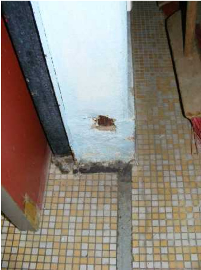
Bild 18: Zustand der Deckenfugen (Dichtstoff spröde Korrosion an der Türzarge)
