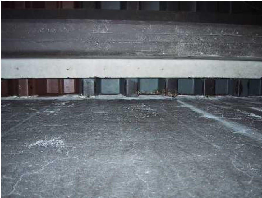
Bild A7: Korrosion der Trapezbleche an den Außenwandbereichen
