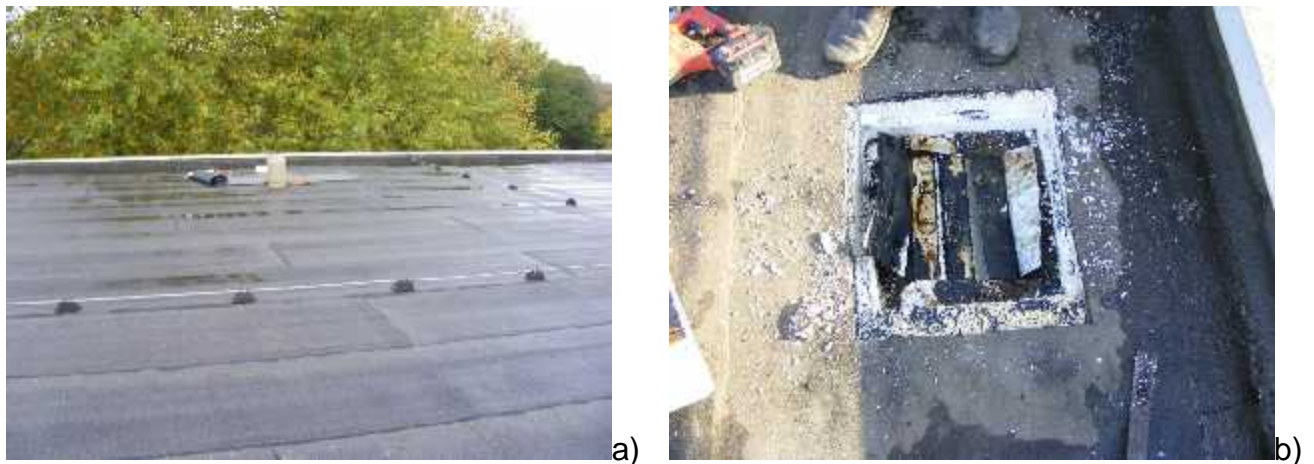
Bild 9: Öffnung der Dachhaut über der Schwimmhalle an der Traufseite zur Liegewiese a) Panoramabild, b) 12 cm Polystyrolschaumdämmung durchfeuchtet
