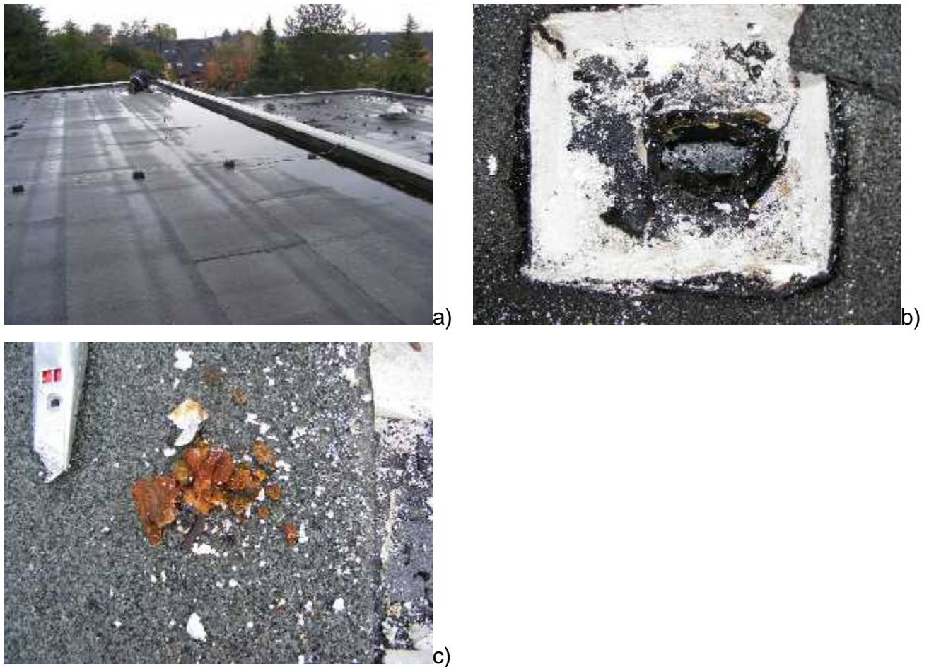
Bild 8: Öffnung der Dachhaut über der Schwimmhalle in der Nähe des Schwimmmeisterbüros a) Panoramabild, b) 12 cm Polystyrolschaumdämmung (trocken), c) Korrosionsprodukte des durchgerosteten Trapezbleches
