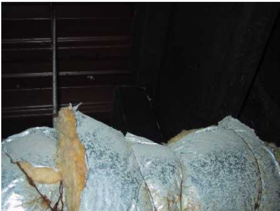
Bild A8: Zustand der Dämmung von Haustechnikleitungen
