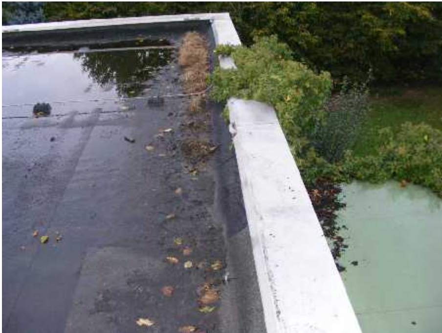
Bild 13: Beispiel für beginnenden Pflanzenbewuchs entlang der Attika und auf den Dachflächen (rechts im Bild zeigt sich das Dach des Anbaus für Mitarbeiter und einen Bürobereich, das eine Foliendacheindichtung hat, die schon bewachsen ist)
