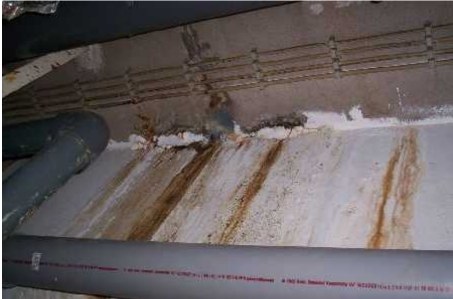
Bild 17: Zustand der Beckenrandfuge von 2005
