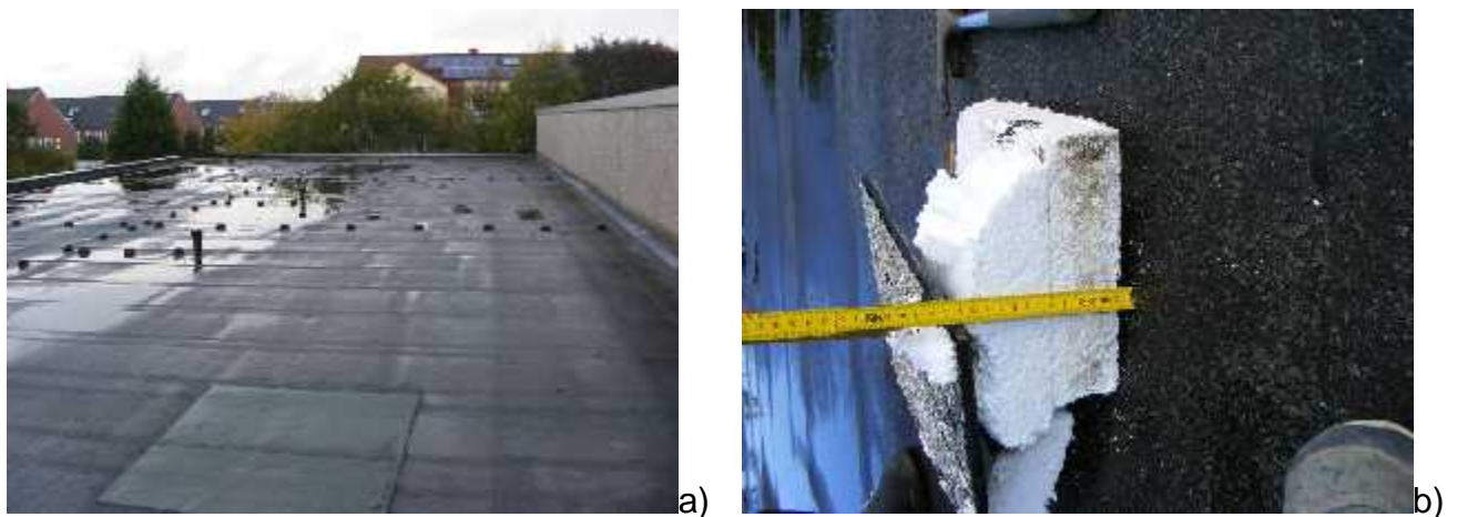
Bild 10: Bauteilöffnung der Dachfläche des Damenumkleidetraktes a) Panoramabild; b) untersuchte Dämmung, der Dachaufbau war an dieser Stelle trocken
