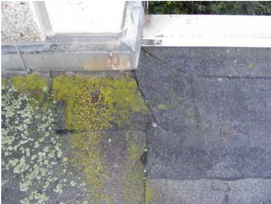
Bild 12: Beispiel für aufgerissene Schweißbahnnaht
