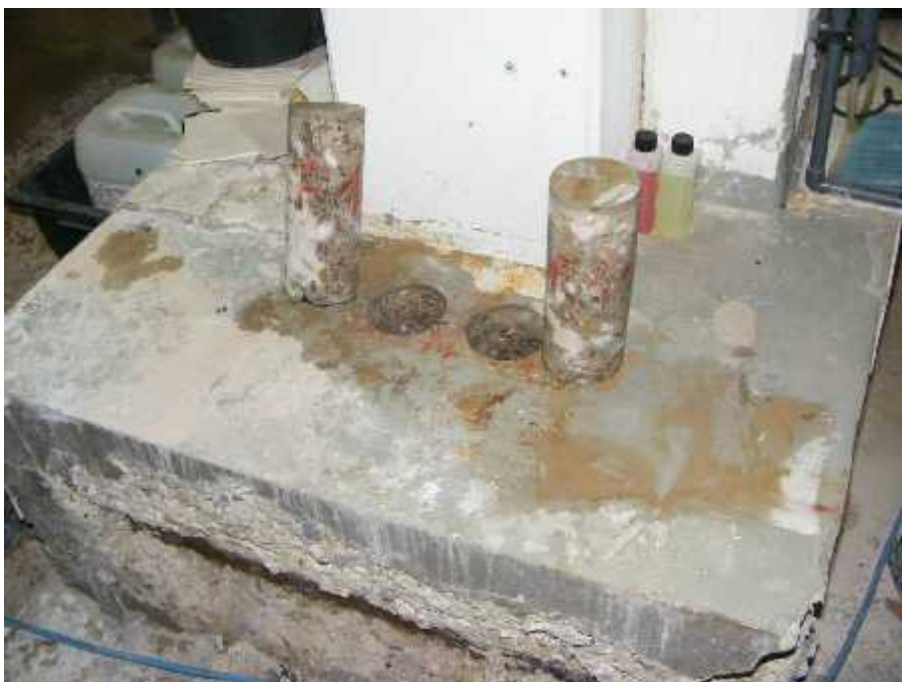
Bild A2: Bohrkernentnahmestellen F1 und F2 im Bereich des Fundamentes, Betonabplatzung an der Fundamentseitenfläche mit deutlichem Bewehrungsverlust.
