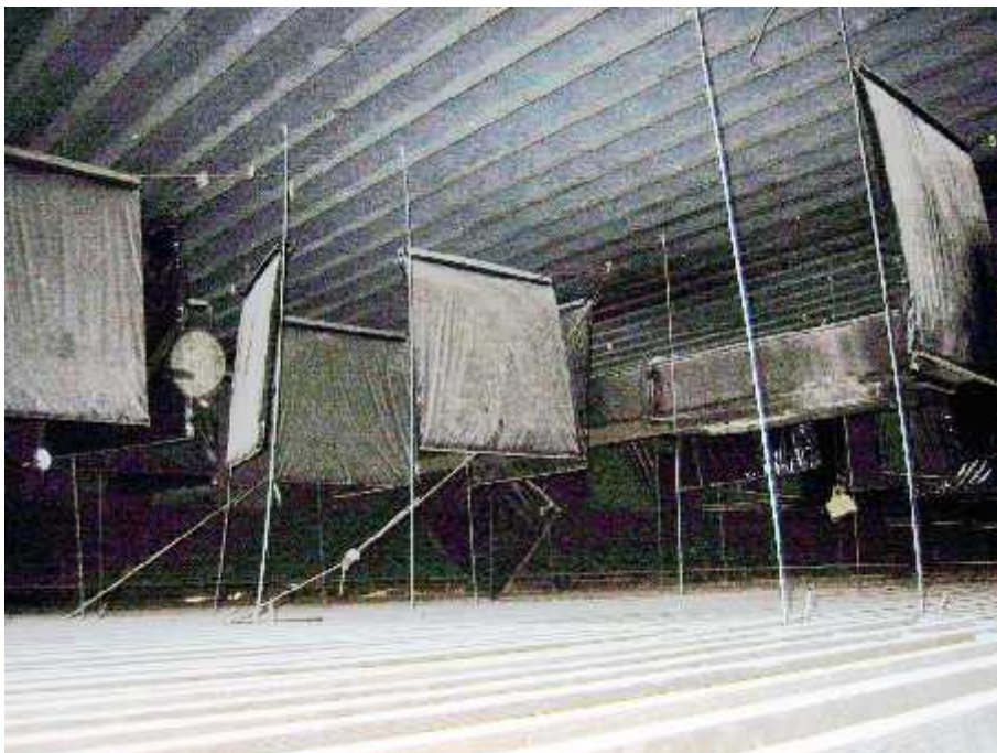
Bild A6: Aufhängung der Absorber in der Schwimmhalle
