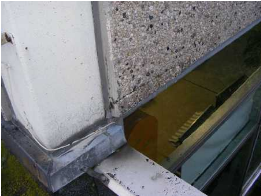
Bild 19: Dichtstoffuge mit Flankenabriss, Abplatzung der Waschbetonecke des Fertigteilrandträgers infolge karbonatisierungsinduzierter Bewehrungskorrosion
